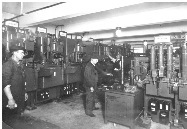
5000 voltin kojeistohuone 1930-luvulla. Kuvan laitteistot asennettiin vuonna 1929. Takana oikealla pilkottaa kierreporras yläkerroksen valvomoon. HelEn
