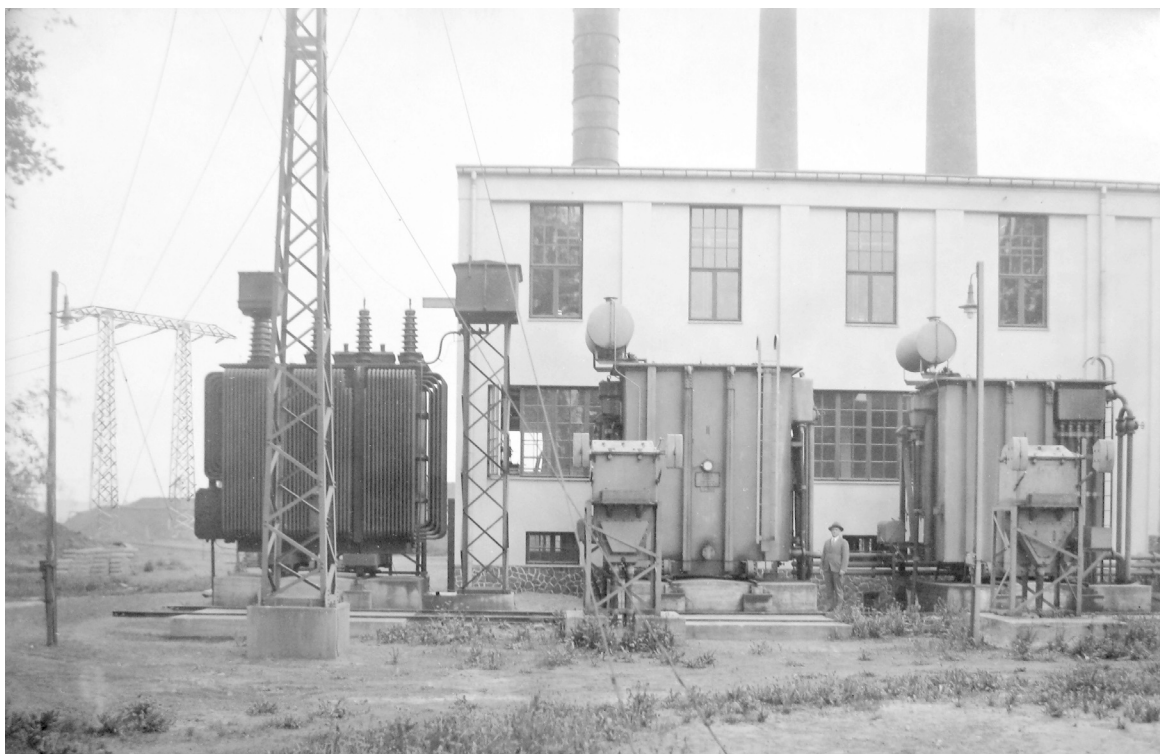
Vesivoimamuuntajat 35 kV:n kytkinlaiterakennuksen edustalla 1930-luvun alkupuolella. Vasemmalla Etelä-Suomen Voima Oy:n 10 000 kilovolttiamppeerin muuntaja ja sen vieressä kaksi Imatran Voiman 14 000 kilovolttiamppeerin muuntajaa. HelEn
