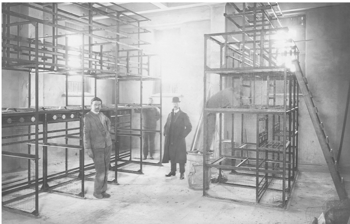
Valvomon marmoripintaiset säätötaulut valmisti Siemens-Schuckertwerke. Lattian lasitiiliaukoista oli yhteys alla sijaitsevaan kytkinhuoneeseen, joka alla olevassa kuvassa on laiteasennuksiltaan keskenäinen. HelEn
